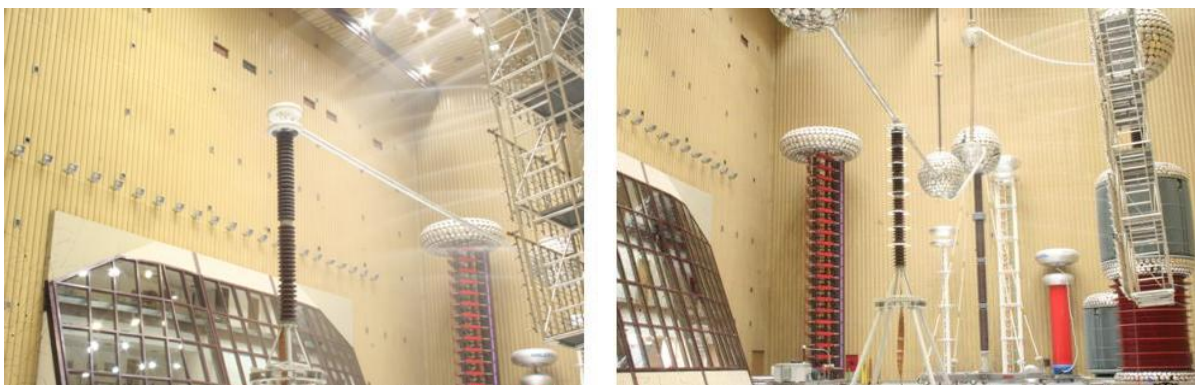
Figura 11 – Instalação dos IP na extremidade e meio do barramento conforme ensaiados no Laboratório de Alta Tensão do CEPEL
